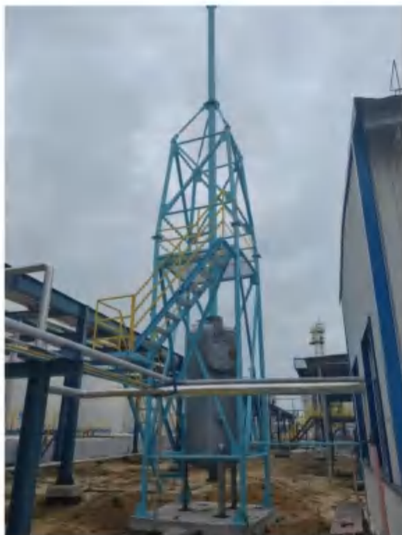
桶装站废气处理设施排气筒
