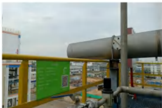
聚碳酸酯颗粒料仓排气筒（DA011）标识牌
