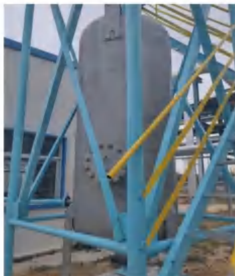
桶装站有机废气收集处理设施
