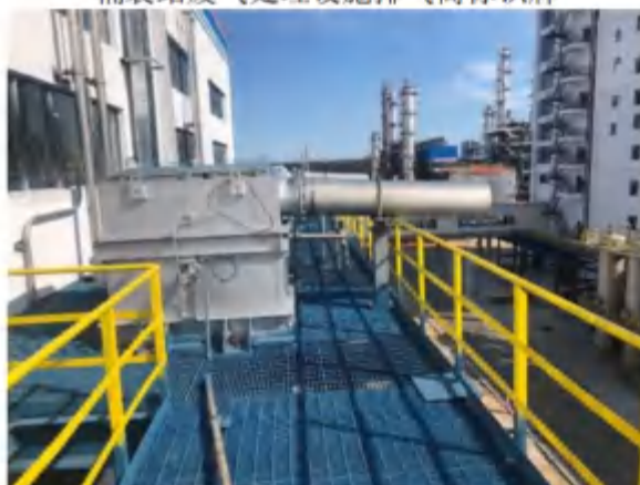
聚碳酸酯颗粒料仓排气筒 (DA012)
