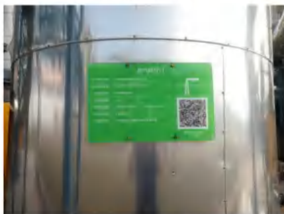
导热油炉排气筒排气筒标识牌
