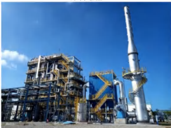
废气废液焚烧系统
