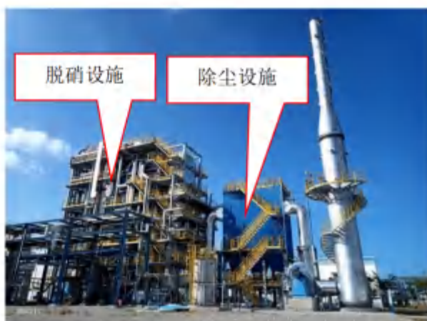
焚烧炉脱硝设施和除尘设施
