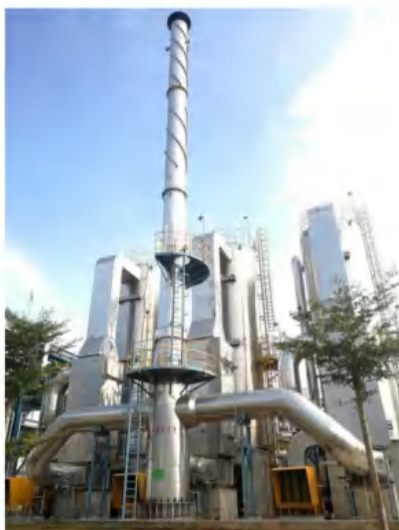
导热油炉排气筒
