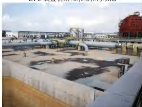
雨水监控及提升池
