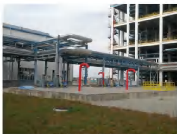
PC 装置初期雨水池和污水池
