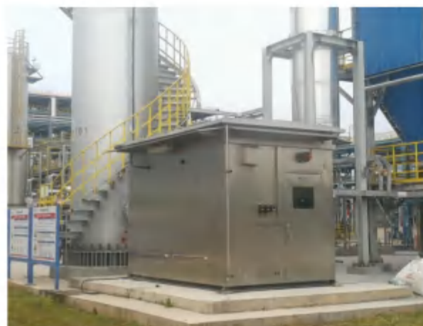
焚烧炉排气筒在线监测分析小屋
