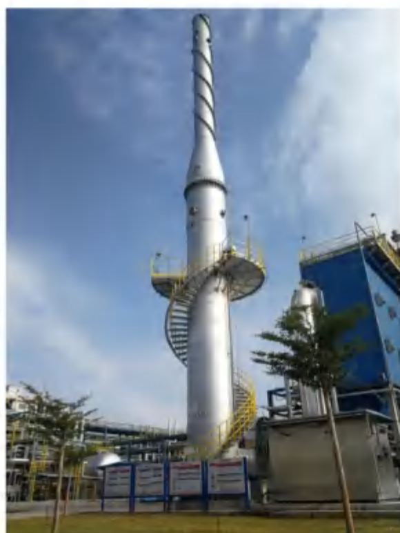
焚烧炉排气筒
