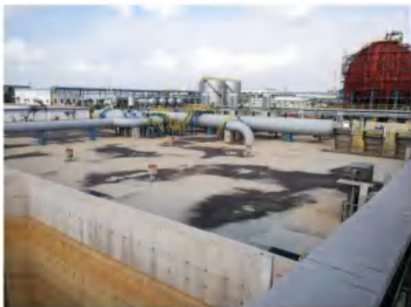
雨水监控及提升池
