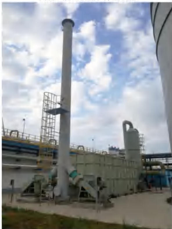
污水处理站有机废气收集处理设施
