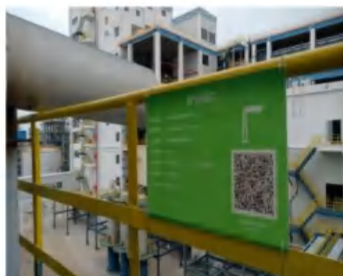
聚碳酸酯颗粒料仓排气筒（DA012）标识牌
