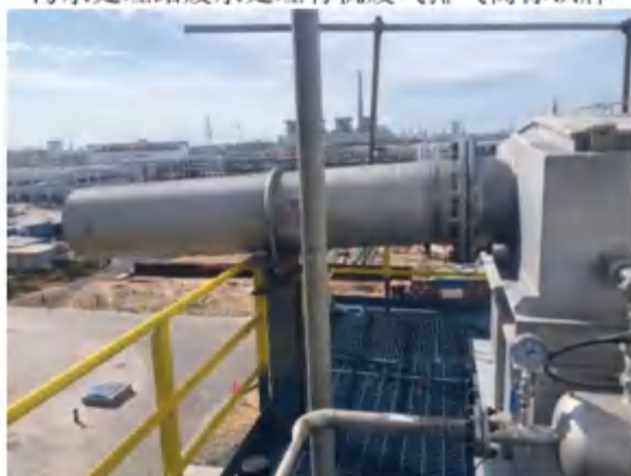
聚碳酸酯颗粒料仓排气筒 (DA011)
