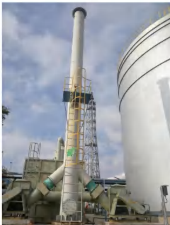
污水处理站废水处理有机废气排气筒
