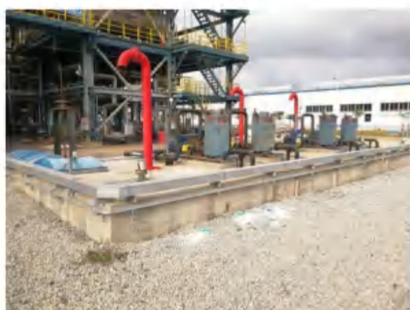
DPC 装置初期雨水池和污水池
